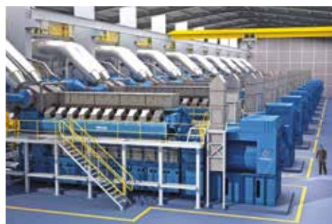
„The Power of 10“ – eine modulare Microgrid-Energielösung mit 10-MW-Bergen-Motoren, Marelli-Generatoren und Stabilisierungstechnologie von Piller ermöglicht die schnelle Bereitstellung von Energie in großem Maßstab.“
